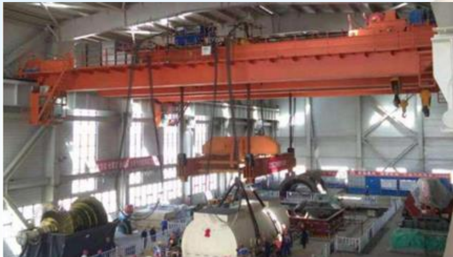
Мостовой кран 148 / 30 тонн ГЭС машинный зал
