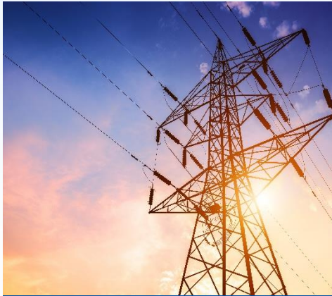
ЛЭП и ПС
