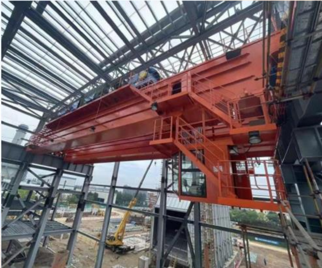
46-тонный кран EOT
