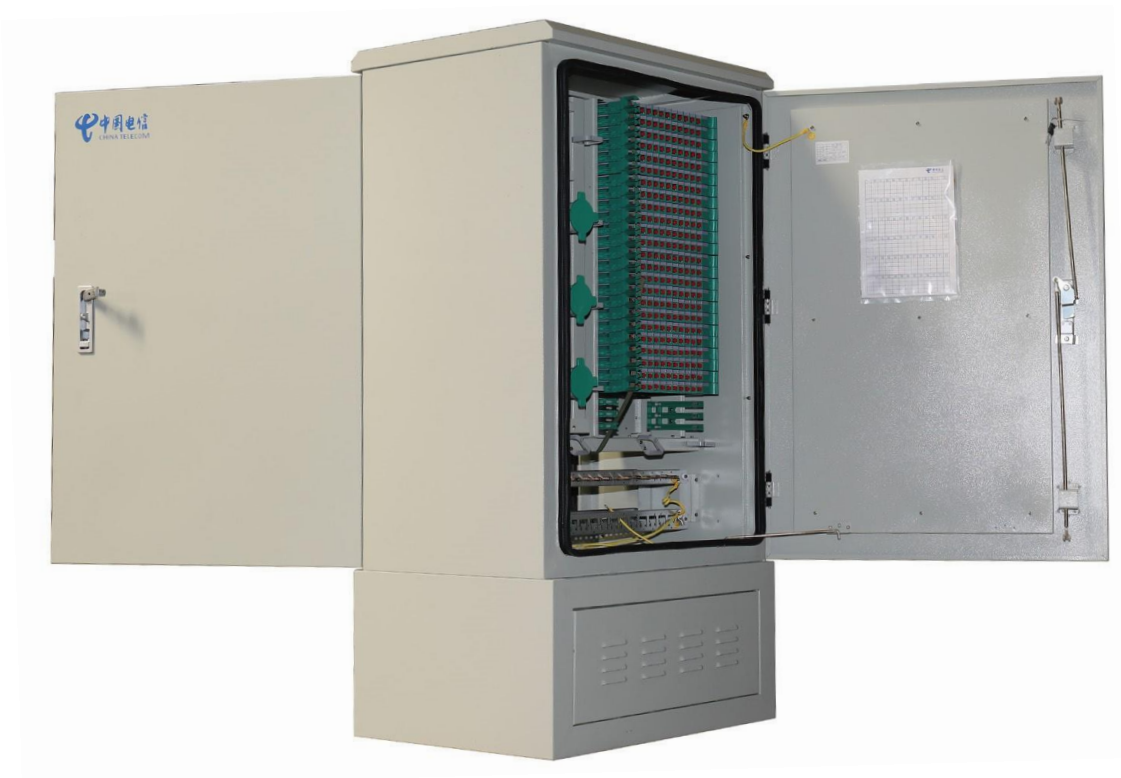
Шкаф ODF с кроссовым соединением 576 Core
