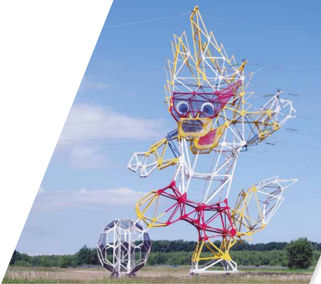
Опора ВЛ «Волк Забывака», г. Калининград. Укомплектована изоляторами АО «ЮМЭК», линейной арматурой и устройствами птицевезащиты ООО «МЗВА»
