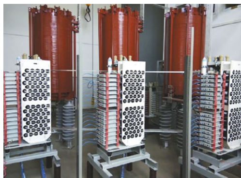
Рис. 17. Блоки тиристорных вентилей БВ ТВ-835/8,27 УХЛ4.2 с реакторами РФ30С-20-2200-0,03 УЗ
