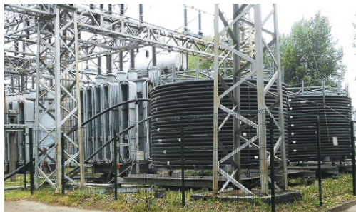
Рис. 10. Общий вид 860-метровой ВТСП КЛ на полигоне
