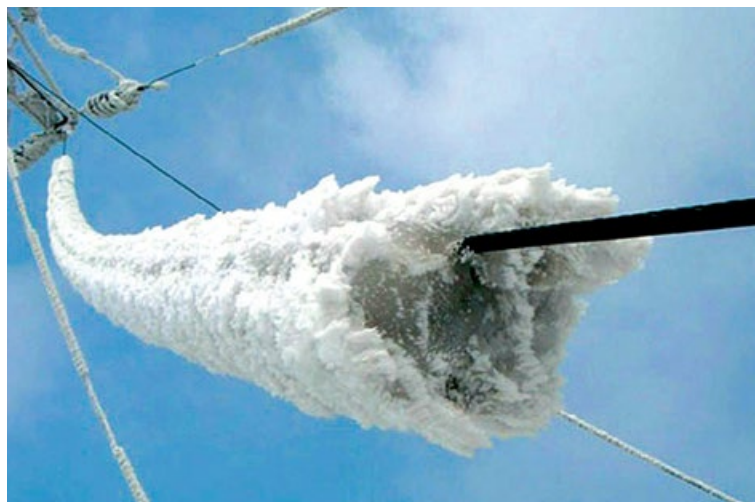
Рис. 4. Гололедно-изморозевые отложения на элементах ВЛЭП
