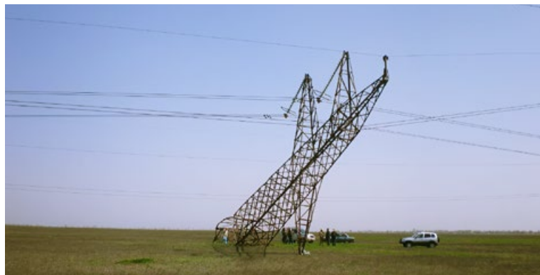
Рис. 1. Упавшая опора ВЛЭП
