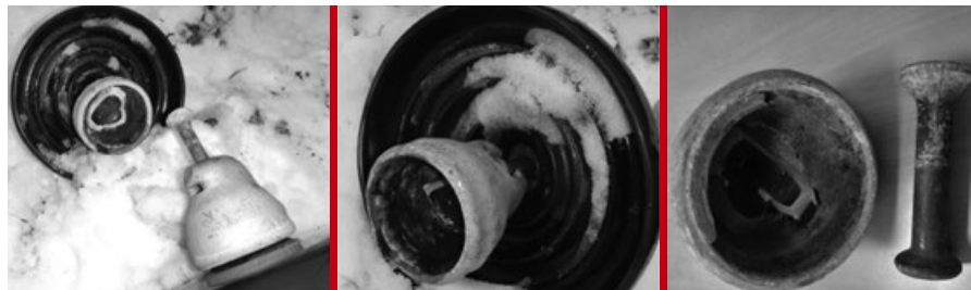
Рис. 2. Повреждение головки фарфорового изолятора с последующим падением провода на ВЛ 110 кВ
