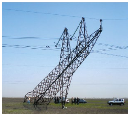
Рис. 5. Упавшая опора ЛЭП
